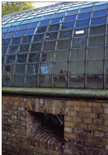
Obr. 39: Otvor v podezdívce slouží k nasávání chladnějšího vzduchu v Neue Glienicke. (Foto E. Choosta, 2009)
