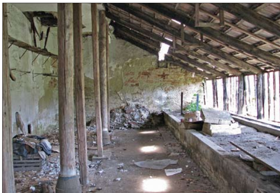
Obr. 54: Stav oranžerie před započatím obnovy. (Foto D. Fetterová 2009)
