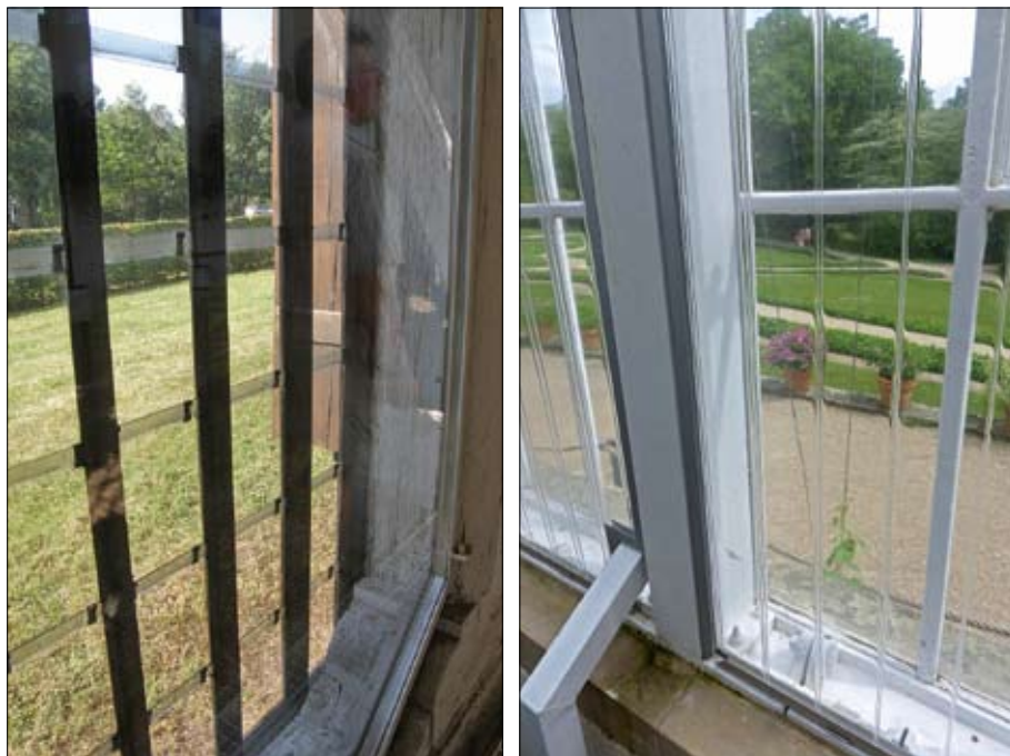
Obr. 45: Možnosti zlepšení tepelně izolačních vlastností prosklených částí skleníku vložením novodobé konstrukce za původní okna stavby. (Foto L. Křesadlová, 2009)
