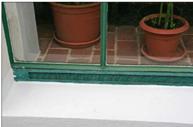
Obr. 35: Kovová mřížka pro nasávání chladnějšího vzduchu nad podlahou v oranžerii v Raduši. (Foto E. Choosta, 2009)
