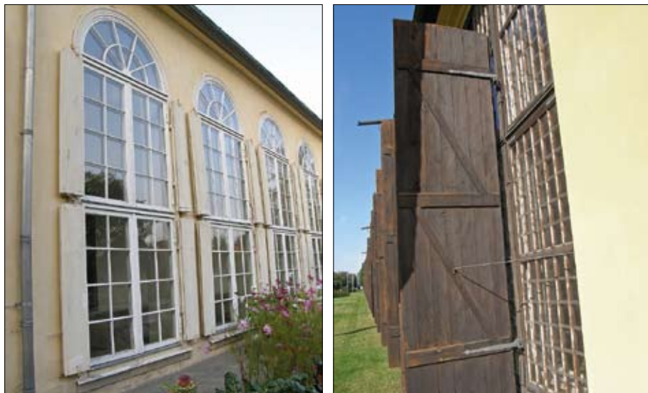
Obr. 34: Okenice pro omezení úniku teploty v nočních hodinách v Sanssouci a Oranienbaum. (Foto L. Křesadlova, 2009)
