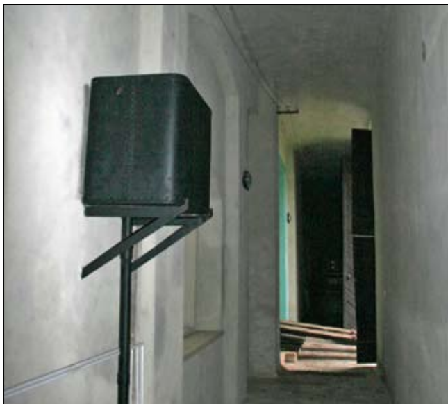
Obr. 46: Již nefunkční expanzní nádoba pro teplovdnní kanálové topení byla zachována spolu se starými rozvody el. energie jako zajímavý doplněk interiéru obslužné chodby Palmového skleníku Květné zahrady v Kroměříži. (Foto J. Olšan, 2014)
